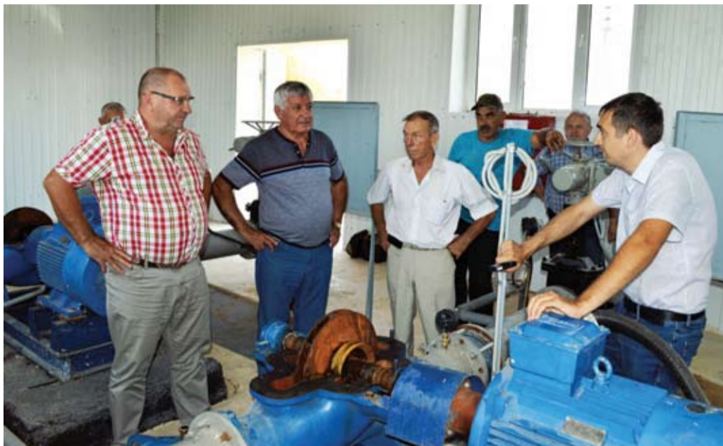
Машинный зал РЭС НС-42
